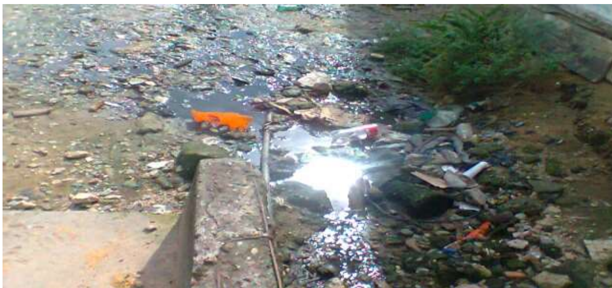
PROBLEMES DE DRAINS AU QUARTIER NEW BELL CONGO
