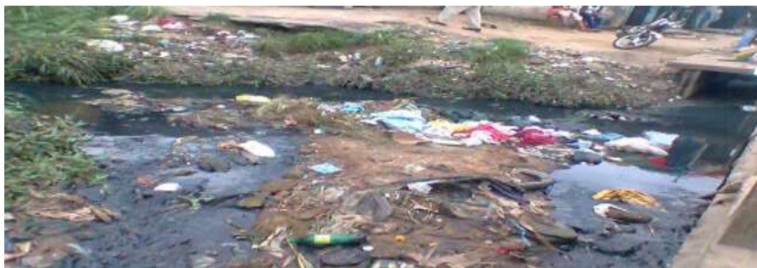
PONT LE PLUS INSALUBRE DU CAMP YABASSI
