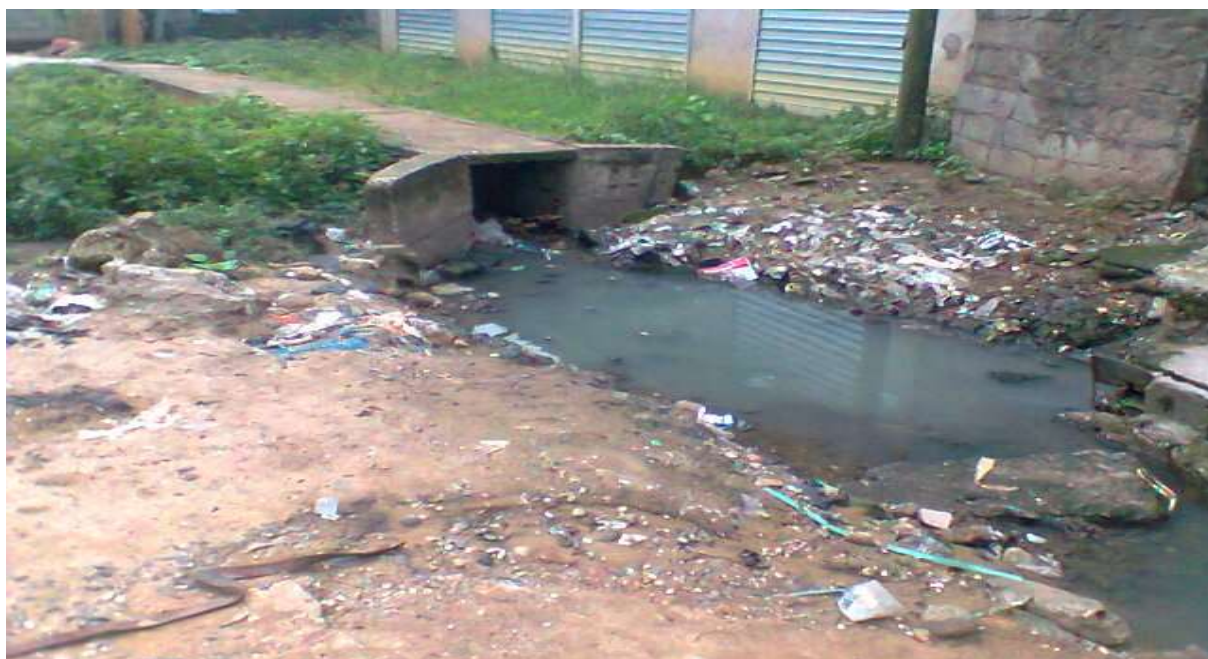
PROBLEMES DE DRAIN AU QUARTIER KASSALAFAM
